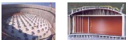
Tanque de almacenamiento de gas, Grecia
